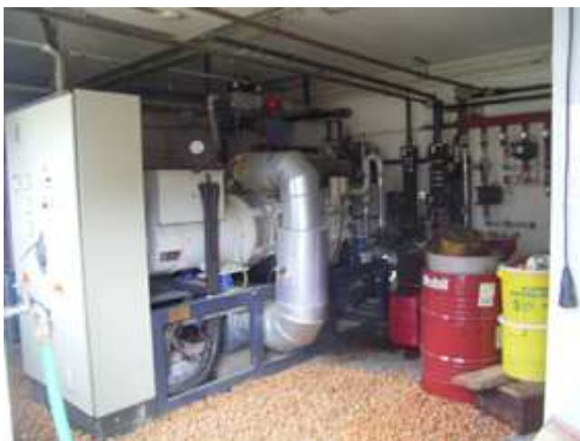
Im BHKW (Blockheizkraftwerk) werden Strom und Wärme aus Biogas erzeugt.
