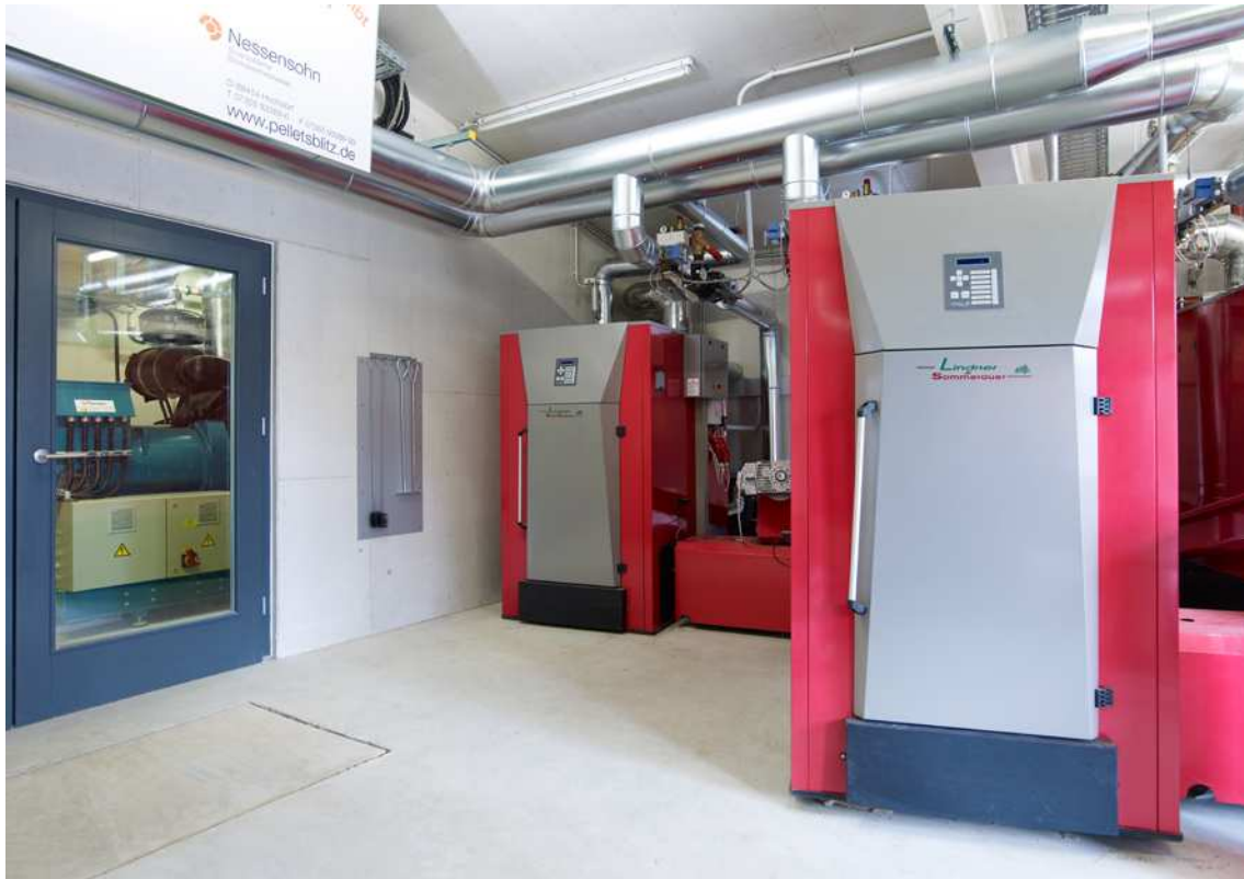
Blick in die Heizzentrale (Bild vom Bioenergiehof Lippertsreute)
